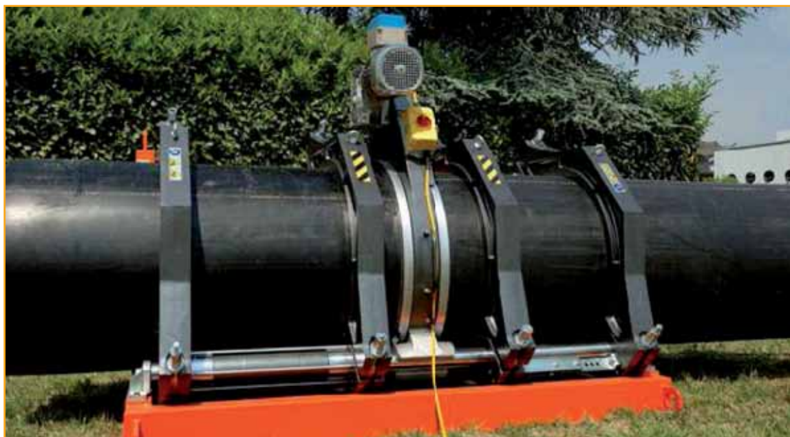
Figura 1. Soldadura a tope por fusión de tubos de PE en campo / Figure 1 Butt fusion welding of PE pipes in the field.
